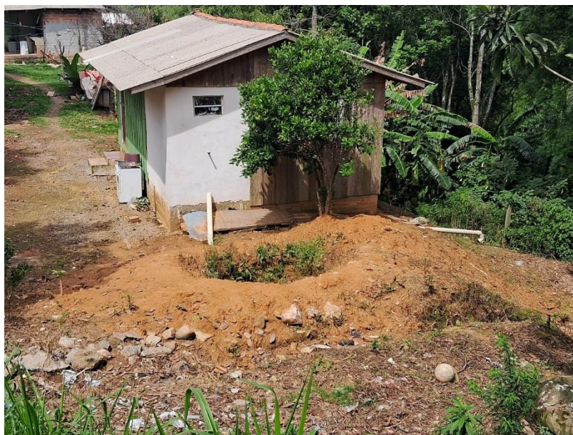
FIGURA 49 – CAVIDADE ABERTA PARA RECEBER EFLUENTES DE RESIDÊNCIA NA CRQ VEM
